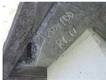
主桁定着金具の露出
