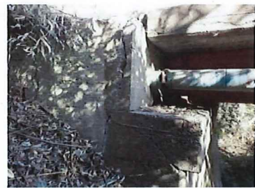
下部工のひびわれ・うき、欠損
