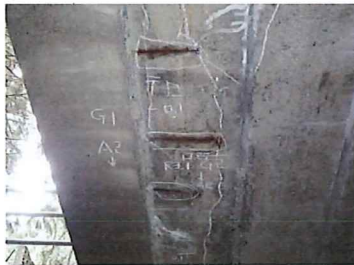
主桁の鉄筋露出
