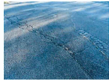
舗装路面のひびわれ、段差
