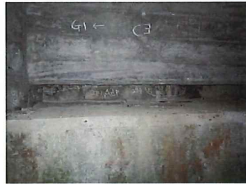
下部工の遊離石灰
