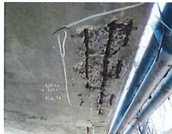
床版の鉄筋露出
