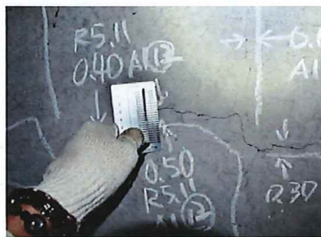
頂版ハンチ部のひびわれ
