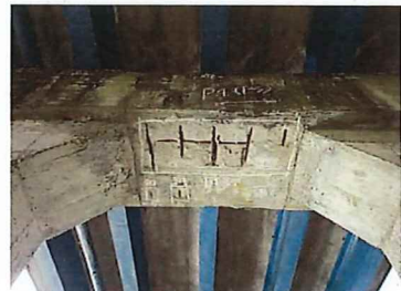
下部工の鉄筋露出
