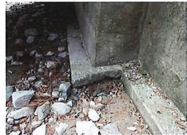
下部工の欠損、洗堀
