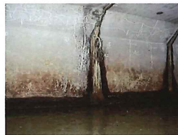
側壁のひびわれ、目地部の遊離石
