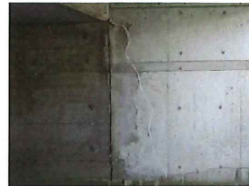
下部工のひびわれ
