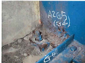
主桁端部の腐食
