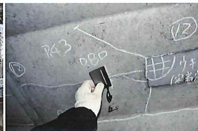
頂版ハンチ部のひびわれ
