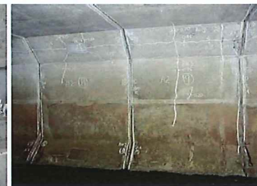
側壁のひびわれ、遊離石灰
