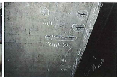
床版の鉄筋露出
