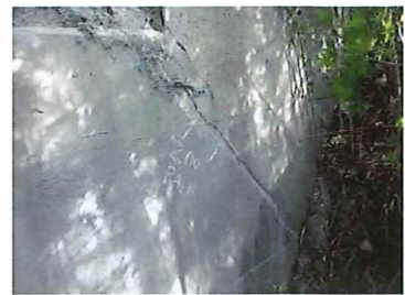
下部工のひびわれ
